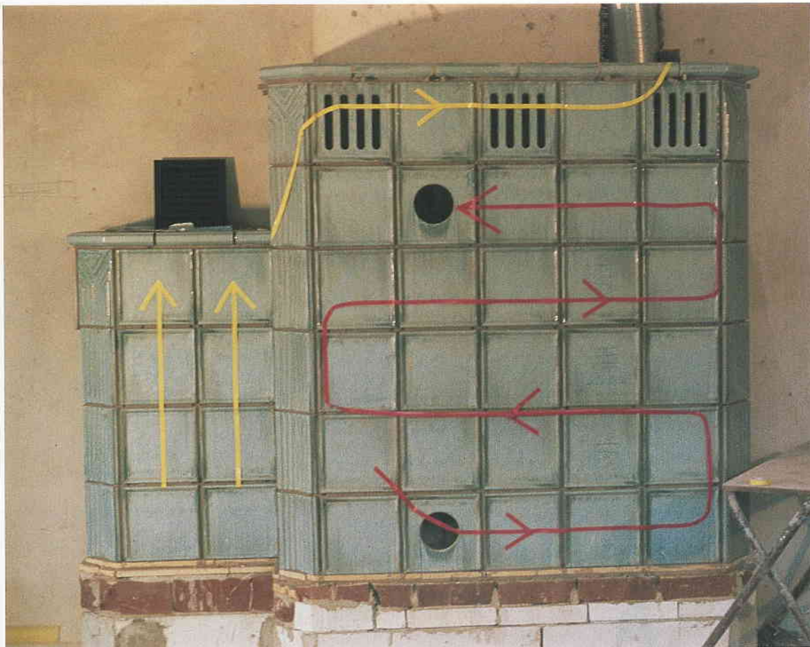
42 Mit umlaufendem Sims versehener Kachelofen mit noch offenen Reinigungsöff- nungen und unverputztem Sockel. Die rote Linienführung zeigt den Verlauf der Rauchga- se durch die Züge, während die gelben Linien die Warm- luftströme andeuten
